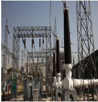
شكل (٣٥) طاقة كهربائية
