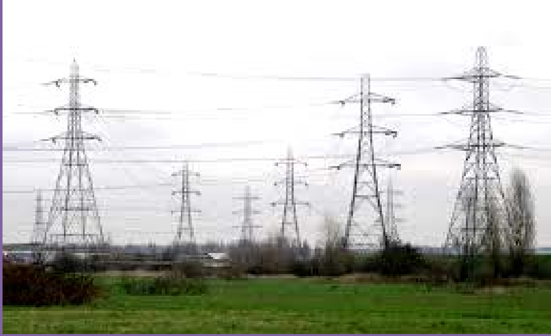
شكل (٢١) خطوط نقل الطاقة الكهربائية
